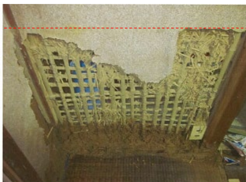
住戸内の被害（居間）
