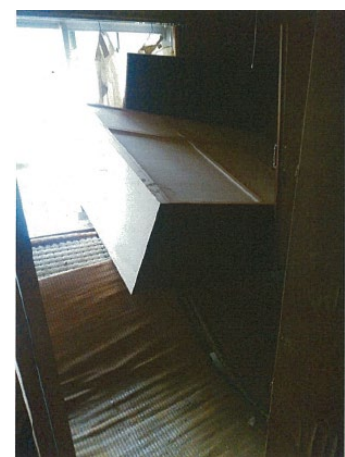
住戸内の被害(居室)
