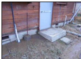
外観浸水状況(10/14)
