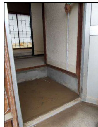
内装被害状況(10/20)
