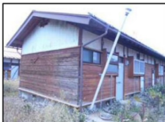
木造外観浸水状況(10/14)
