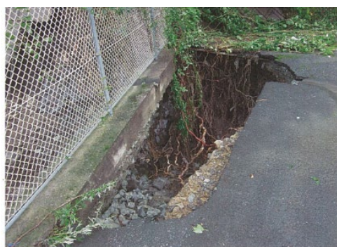
敷地内陥没の状況
